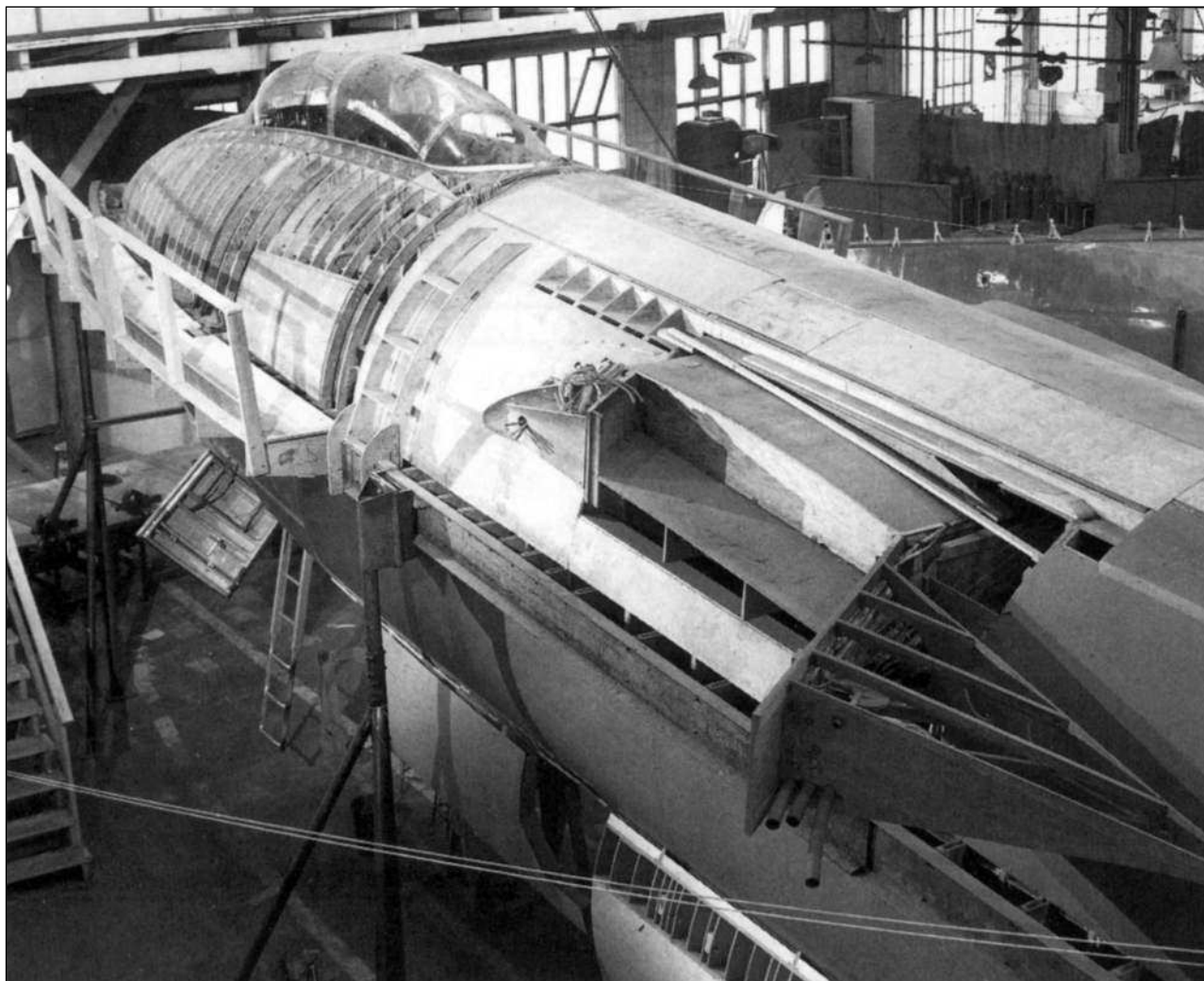
Деревянный макет В-47. Видно сочленение крыла и фюзеляжа. Видны электрокабели (в передней кромке крыла), топливные и гидравлические трубопроводы (за вторым лонжероном). Фонарь кабины установлен. Фото: «Боинг».
